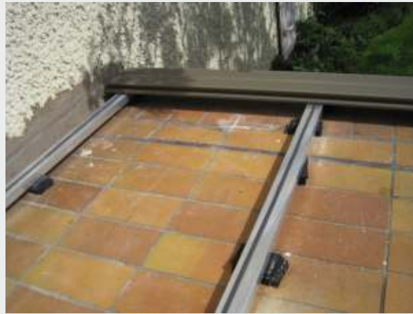
Aluminium Unterkonstruktion mit Pad
